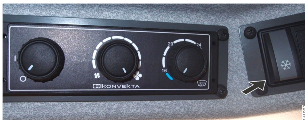
Рис. 190: Главный выключатель кондиционера
