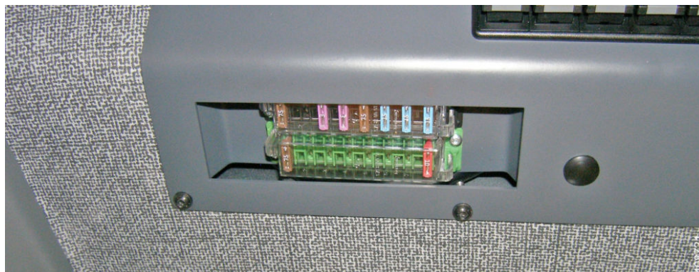
Рис. 361: Предохранители в консоли крыши кабины водителя
