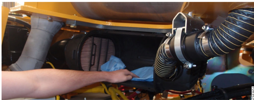
Рис. 439: Очистка корпуса фильтра
